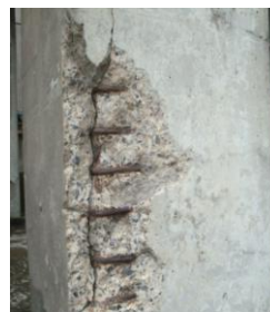
写真-1 劣化が進んだコンクリート
